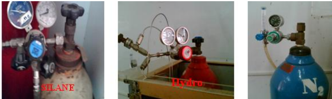
Hình 2.7: Các bình khí Silane, Hydro, Nitrogen dùng trong quá trình tạo mạng.
