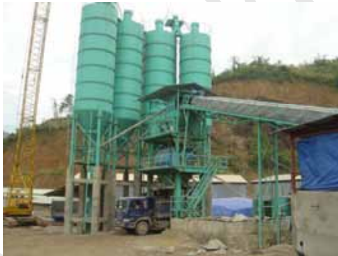
Trạm trộn bê tông tự động
