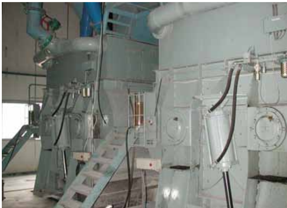
2 máy trộn trực đôi 6 m 3 trong Nhà máy trộn bê tông tại công trình Longtan (Trung Quốc)
