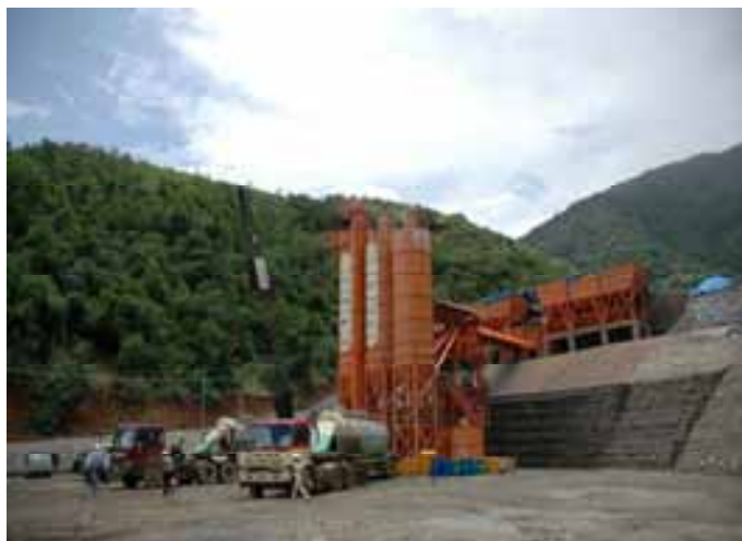
Trạm trộn bê tông có 1 máy trộn trục đôi 3m 3 sử dụng
