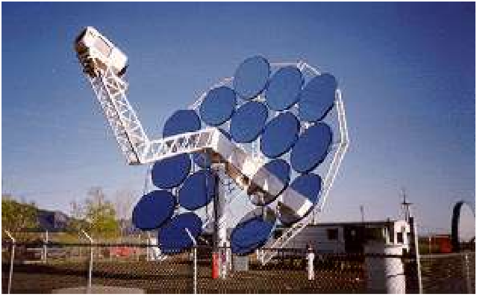
Hình 4.126. Nhà máy điện mặt trời sử dụng các đĩa parabol
