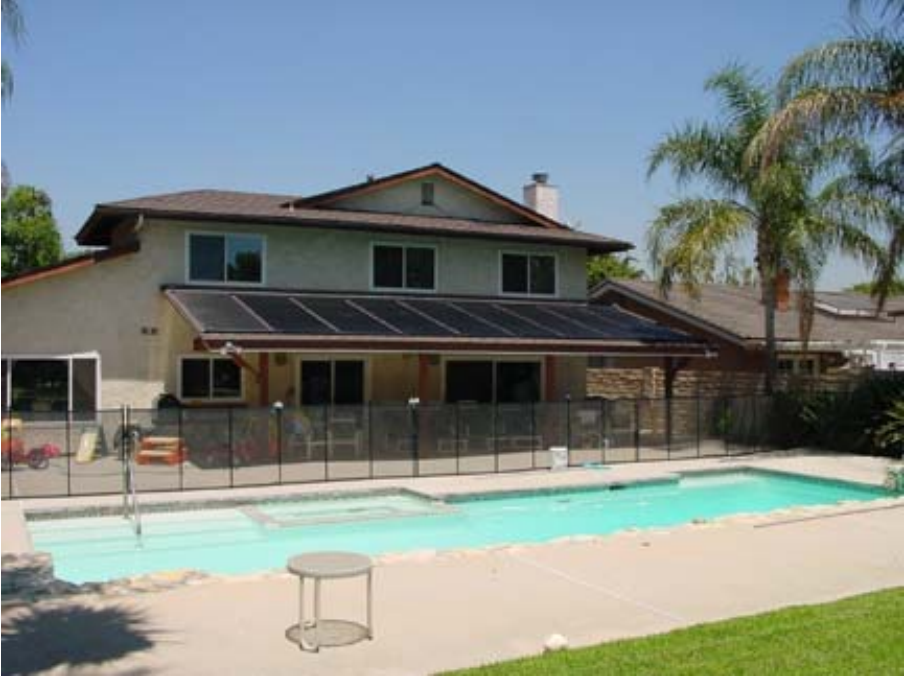
Hình 4.62. Hệ thống hâm nóng bể bơi
