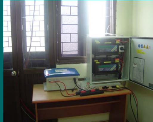
Bộ biến đổi điện Wind Boy, Bộ ắc qui và Tủ điện
